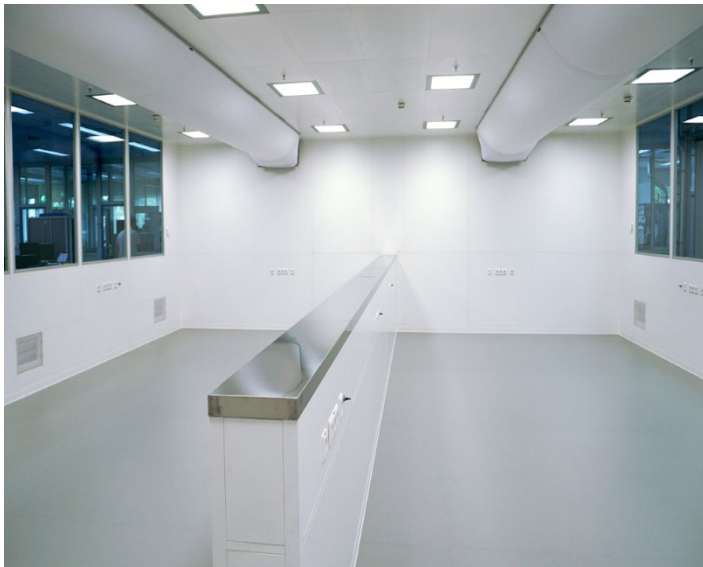
Inauguration de la première salle blanche permanente sur le site de FAULHABER à Schönaich (Allemagne) © FAULHABER
